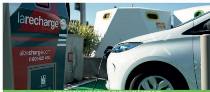
BORNE DE RECHARGE PUBLIQUE DE VÉHICULES ÉLECTRIQUES
